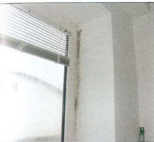
Schimmelbildung in einer Fensterlaibung.
