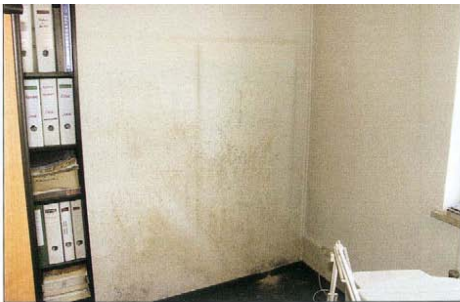
Schimmelbildung hinter der Möblierung an kalter Außenwand.
