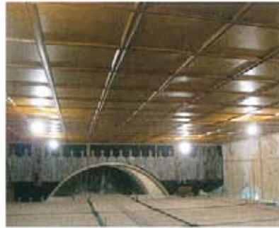
6 Bei der Renovierung Anfang der 1970er-Jahre hatte man eine dunkle Holzkassetendecke eingebaut.
