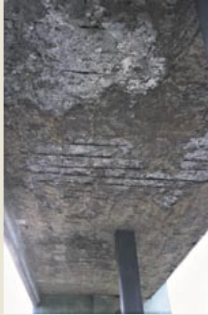
Das Flugdach war so stark geschädigt, dass es komplett neu aufgebaut werden musste.
