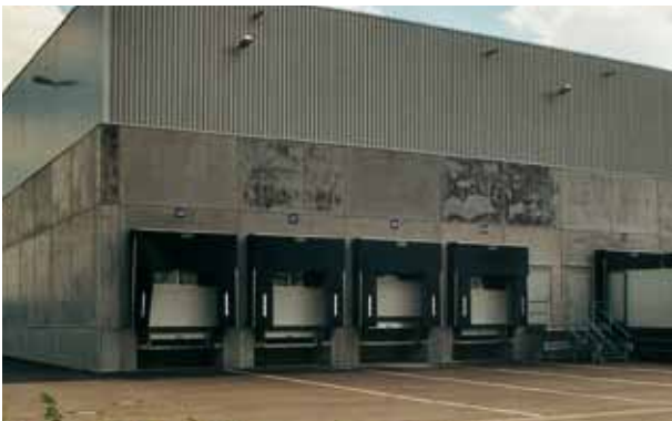
Hormigón nuevo con manchas importantes
