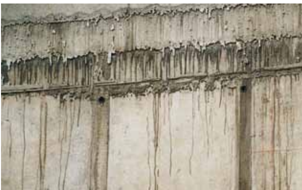
Hormigón nuevo mal ejecutado con necesidad de enmasillado
