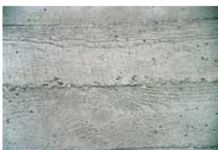
Tratamiento en veladura (sin masilla), las coqueras se mantienen abiertas
